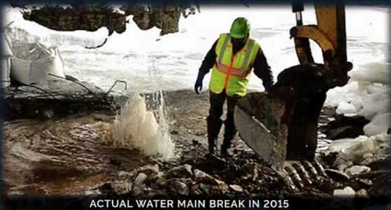
ACTUAL WATER MAIN BREAK IN 2015
